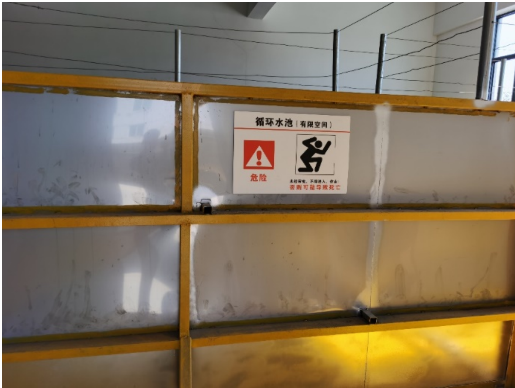
厂区废水处理站（混凝+气浮+过滤池）
